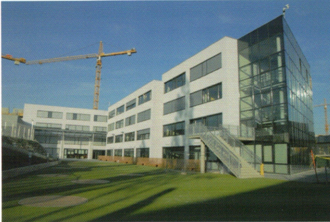
Zukunft im Bau: am nördlichen Nachbargrundstück der neuen Schule entsteht das Maimonides-Zentrum, wo alte Menschen ihren Lebensabend verbringen können. Foto: Dieter Werderitsch
