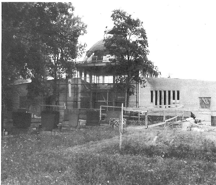
Die Zeremonienhalle der Israelitischen Kultusgemeinde in Graz befindet sich derzeit im Wiederaufbau. Sie wird am 11. November 1991 feierlich eingeweiht werden.
